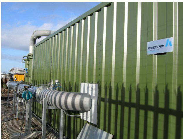
Containeranlage HOFGAS®- IPM/C mit Pumpstation und Steuerung
