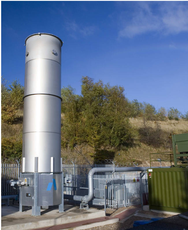
Hochtemperaturfackel HOFGAS® - Efficiency 2500 mit Regelbereich 1:60 und low-noise Brenner 65dBA in 10m
