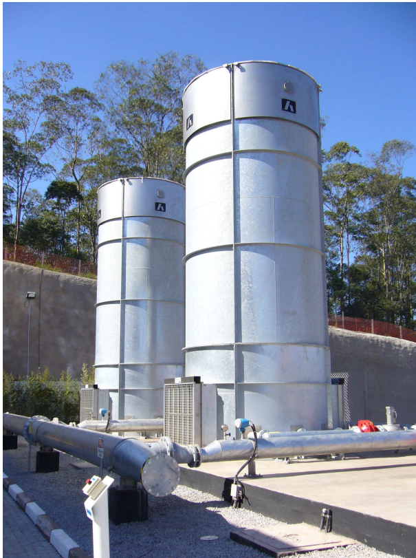
Hochtemperaturfackeln HOFGAS® - Efficiency 5000
