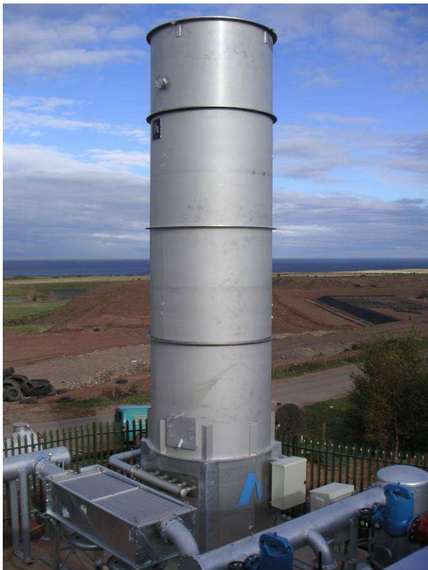
Entgasungsanlage HOFGAS® - LPM 3000
