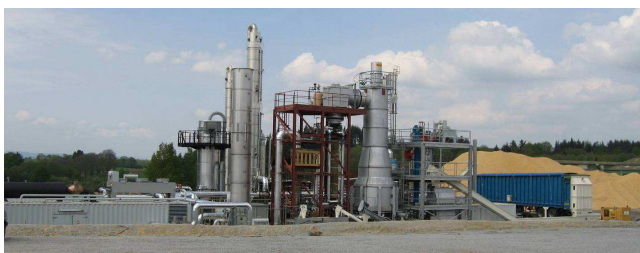
Gesamtansicht der Vergasungsanlage
